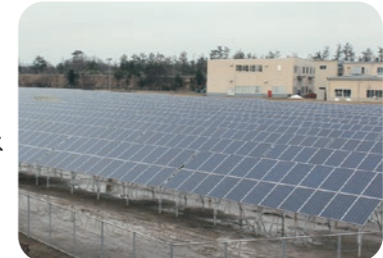
柿崎地区に設置されたメガソーラー
